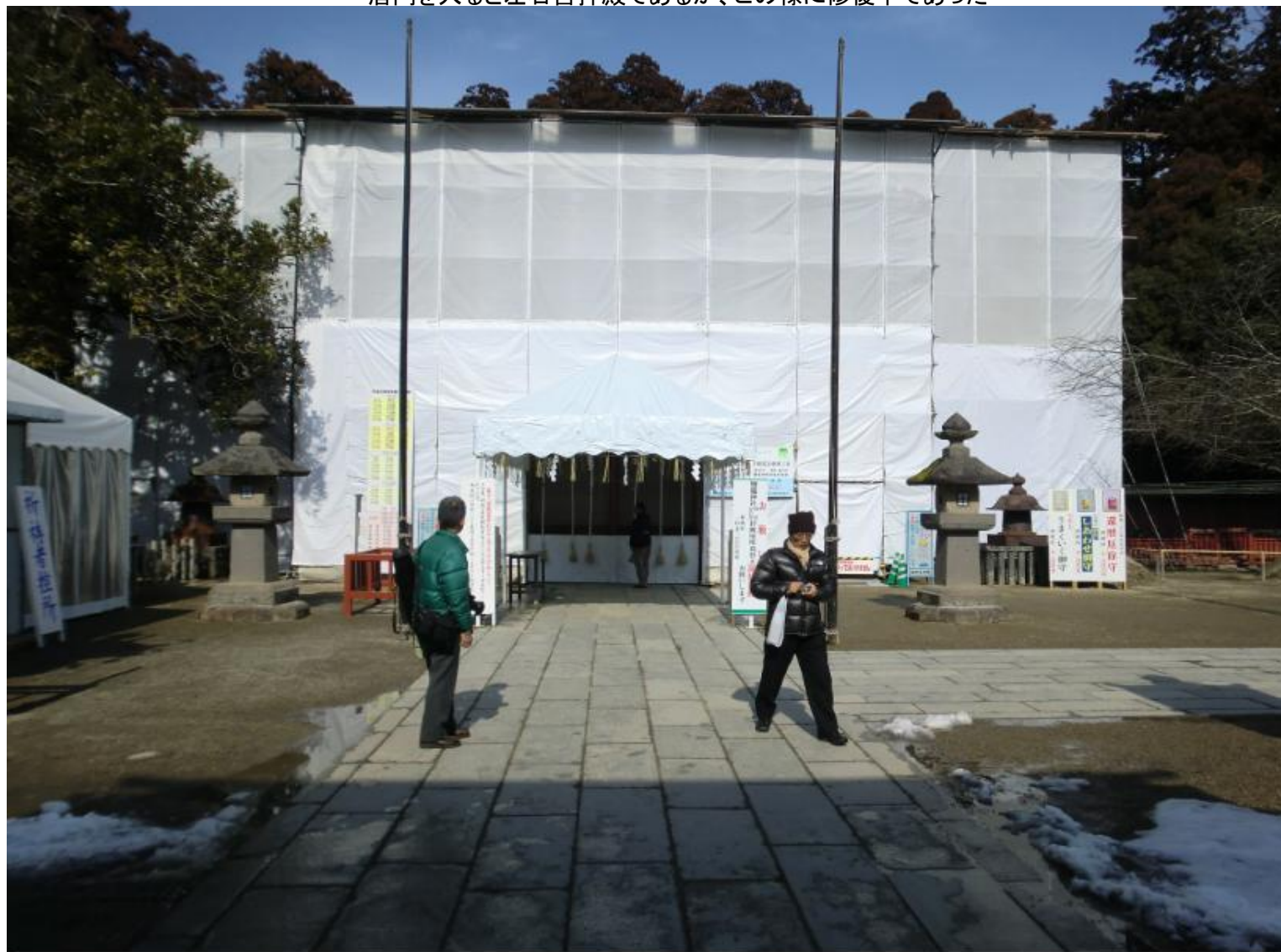
唐門を入ると左右宮拝殿であるが、この様に修復中であった
